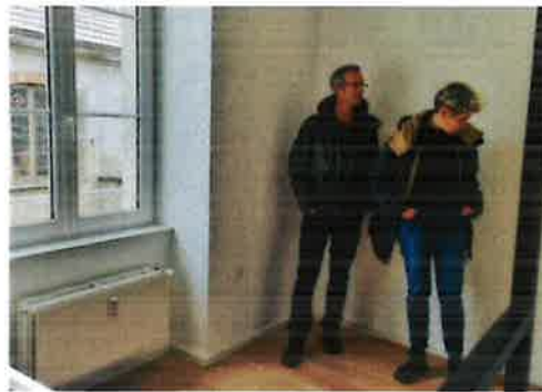
Simon Lurault, responsable du chantier, et Claire Cavaro, à la tête du service de maîtrise d'œuvre d'Un toit pour tous (deux des 42 salariés de l'association), sont venus mercredi inspecter les travaux réalisés dans les trois logements vides.
